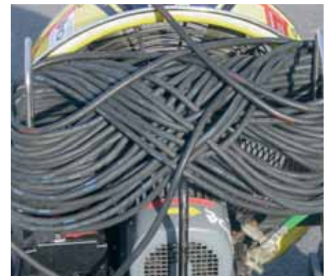
Kabel anfällig auf Verletzung
